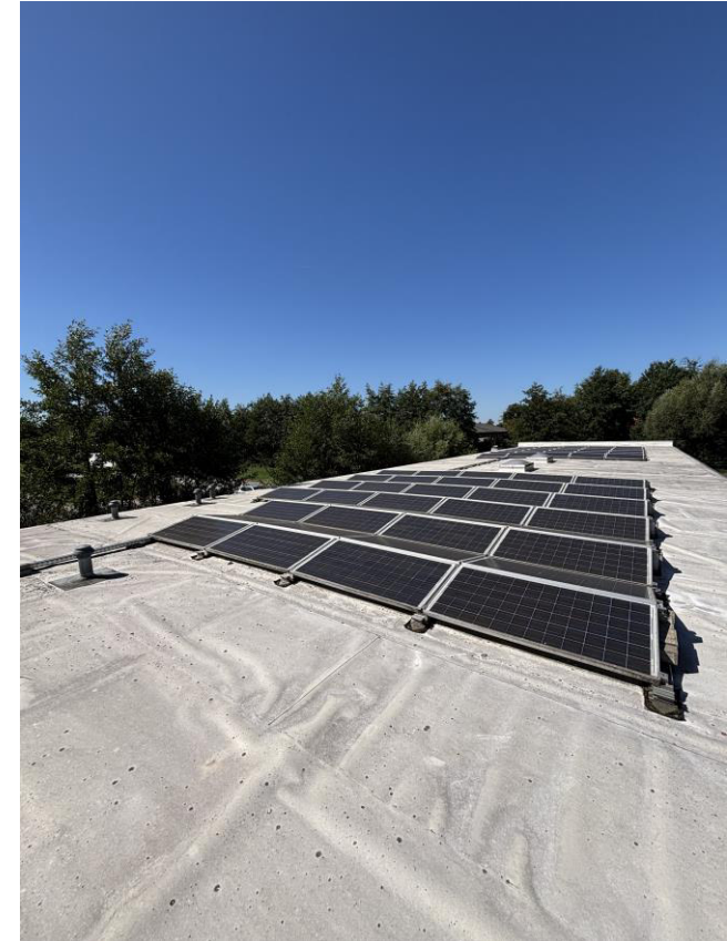
PV-Anlage Jerusalemer Straße 10 (Asylunterkunft)
